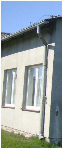
Wgniecenie w rurze spustowej, oraz widoczna korozja biologiczna.
