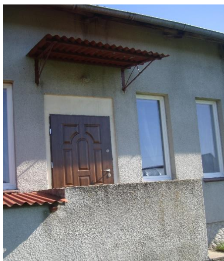
Część elewacji bocznej prawej - ślady zawilgocenia ścian.
