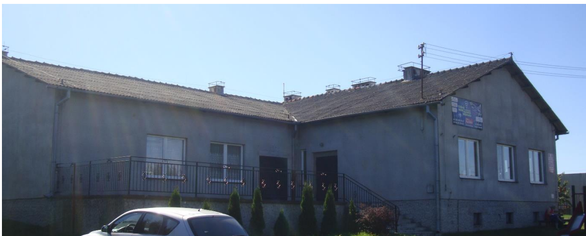
Elewacja frontowa – zawilgocenie ścian, korozja instalacji odgromowej.
