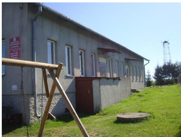
Elewacja boczna lewa – wejście do piwnicy – stolarka drzwiowa wypaczona, wgnieciona rura spustowa.
