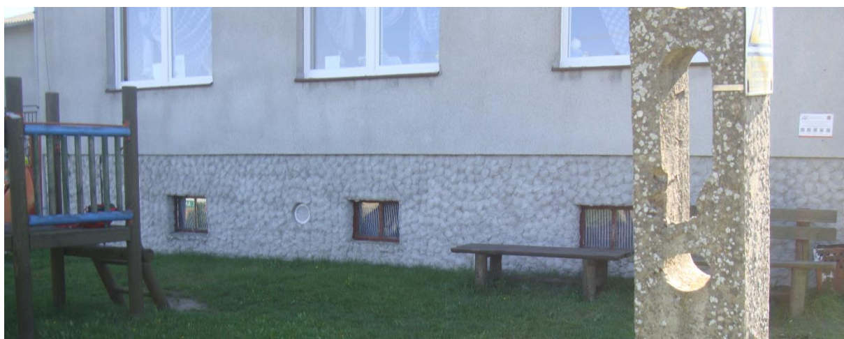
Część elewacji frontowej – wypaczona stolarka okienna drewniana.
