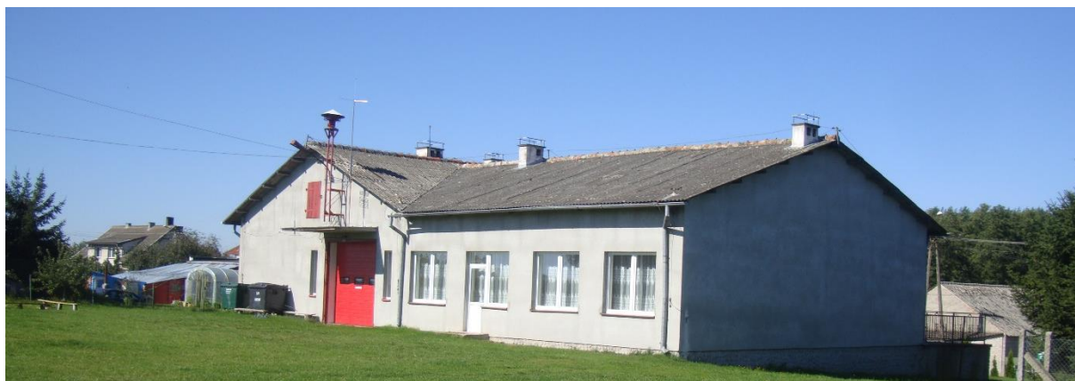
Elewacja tylna oraz część elewacji bocznej lewej – uszkodzenia gąsiorów, miejscowo przerwana instalacja odgromowa, nieszczelność pokrycia oraz zawilgocenie ścian.
