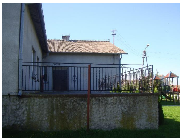
Część elewacji bocznej lewej – widoczna korozja biologiczna bocznej strony schodów. Wody opadowe odprowadzane rynną spływają po cokole budynku powodując jego ciągłe zawilgocenia.
