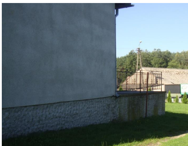
Część elewacji bocznej lewej – widoczna korozja biologiczna bocznej strony schodów oraz zawilgocenie ścian.
