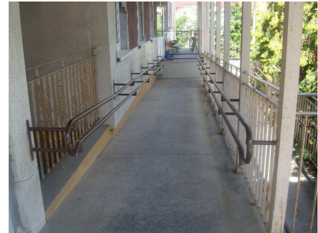
Fragment podjazdu dla niepełnosprawnych widoczna korozja barierek
