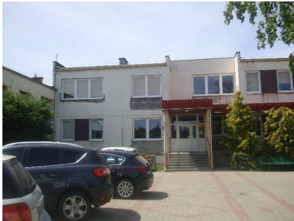
Wejście główne do budynku – miejscami luźny i odpadający tynk; Widoczne ślady korozji na konstrukcji zadaszenia
