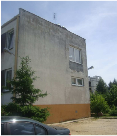
Fragment elewacji tylnej – widoczne ślady korozji biologicznej
