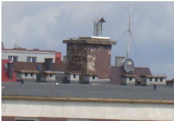
Dach pokryty papą, widoczne uszkodzenie komina
