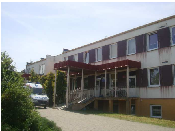
Fragment elewacji frontowej – widoczna korozja biologiczna schodów zewnętrznych
