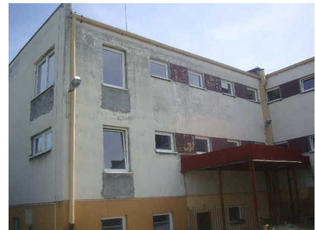
Fragment elewacji tylnej – widoczne ślady korozji biologicznej ścian
