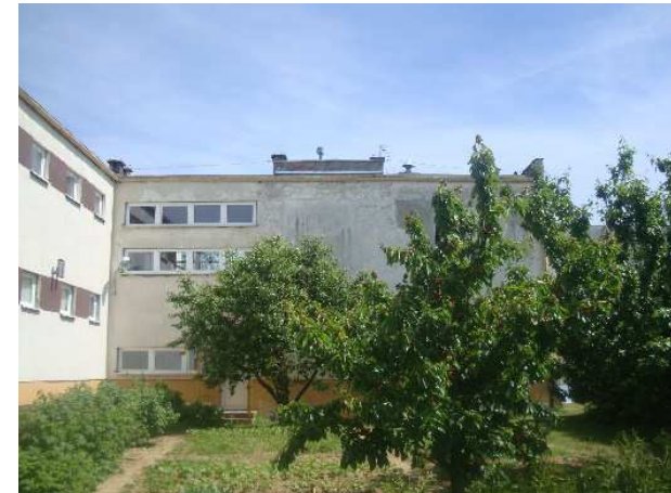
Fragment elewacji tylnej – widoczne ubytki tynku na kominie, korozja biologiczna ścian
