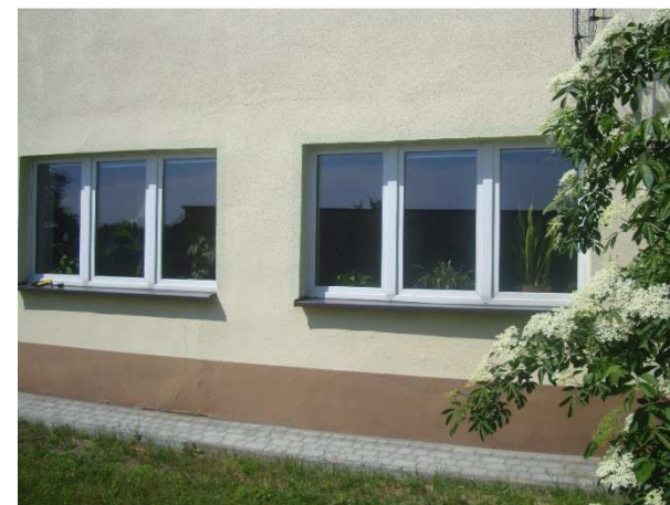
Fragment elewacji tylnej – widoczne zarysowania
