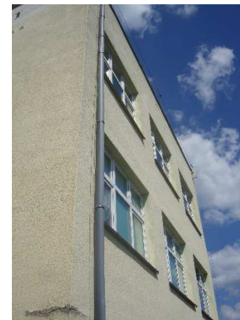
Fragment elewacji tylnej – uszkodzony narożnik budynku
