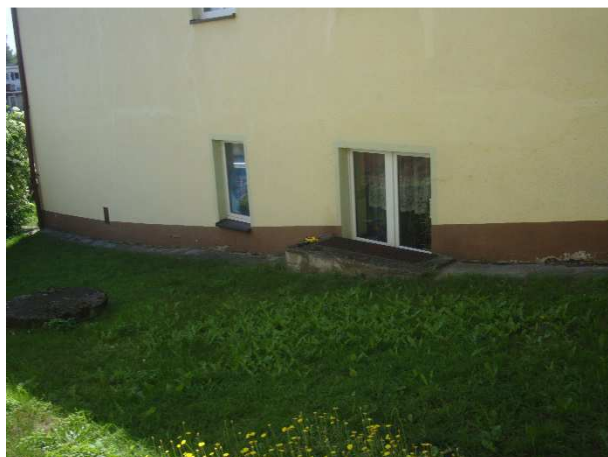
Fragment elewacji bocznej lewej – uszkodzenie cokołu
