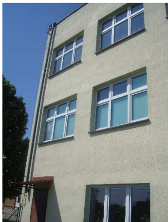
Fragment elewacji tylnej drzwi wejściowe do wymiany
