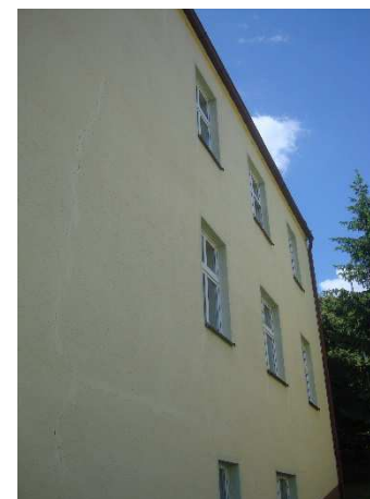
Fragment elewacji bocznej lewej – widoczne zarysowania
