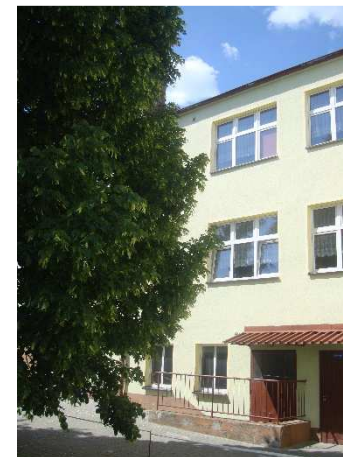
Fragment elewacji tylnej – drzwi do kotłowni – 2 szt. do wymiany; widoczne uszkodzenie murku zewnętrznego
