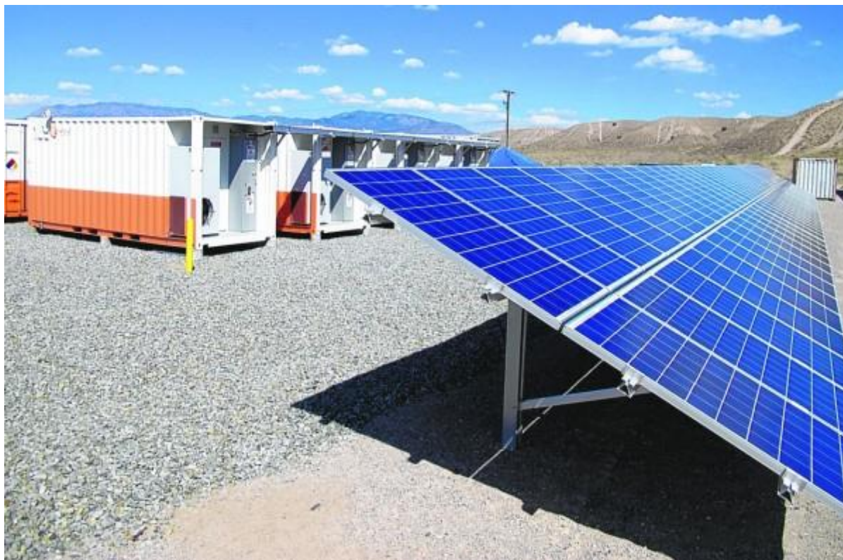
Fotografia 6 Farma fotowoltaiczna z systemem magazynowania energii, lokalizacja Mesa Del Sol rok 2011. Źródło: https://www.abqjournal.com/57568/pnm-solar-storage-system-a-first.html
